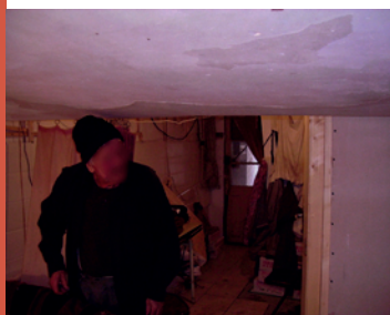
Hauteur sous plafond insuffisante
