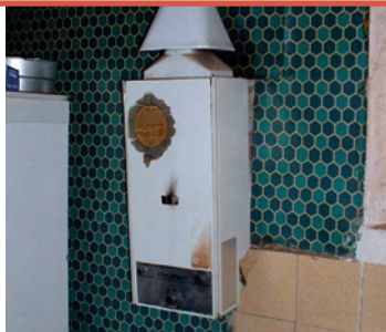
Absence de dispositif d'évacuation des gaz brûlés
