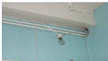
Eclairage insuffisant et dangereux
